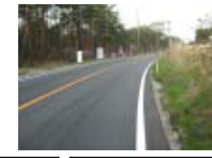
一部歩道未整備
